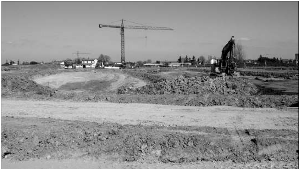
Il nuovo cimitero urbano sta nascendo lungo la Romea, di fronte all'Agria
